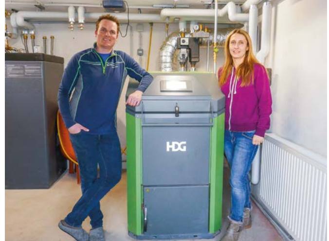
Silke und Hubert Neuhold sind mit der neuen Holzheizung voll zufrieden.
